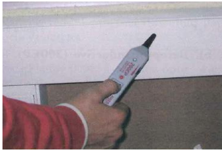
Siguiendo la canalización con el receptor
