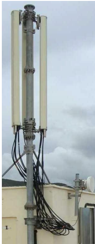
3 antenas GSM en Monoposte + radioenlace
