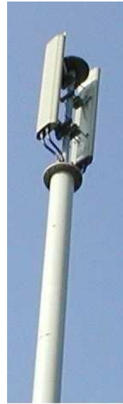
2 antenas UMTS en monoposte
