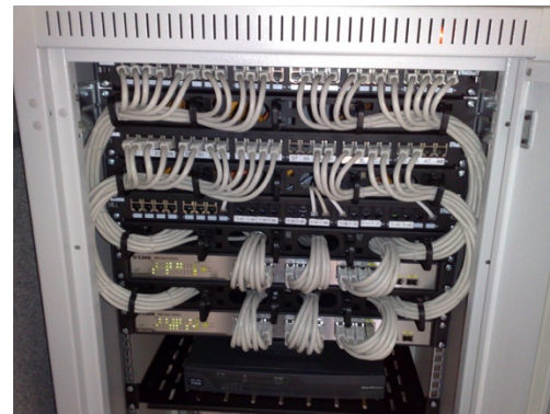
Switches y paneles de parcheo cableados en rack.
