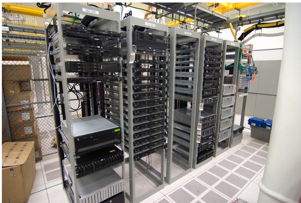
Racks en granja de servidores
